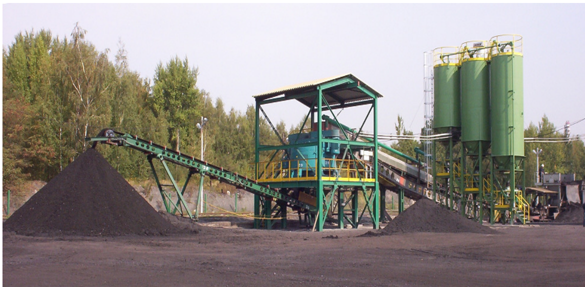
Rys. 2. Stacjonarna instalacja granulacji mułów węglowych w zakładzie produkcyjnym „Haldex-Makoszowy” w Zabrze (materiały własne)
